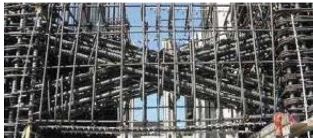
Fig.8. Congestionamiento de varillas en un armado típico de vigas de
